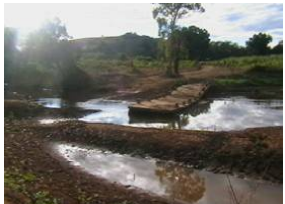
Remblai d'accès emporté sur l'axe Befotaka - Ambaliha
