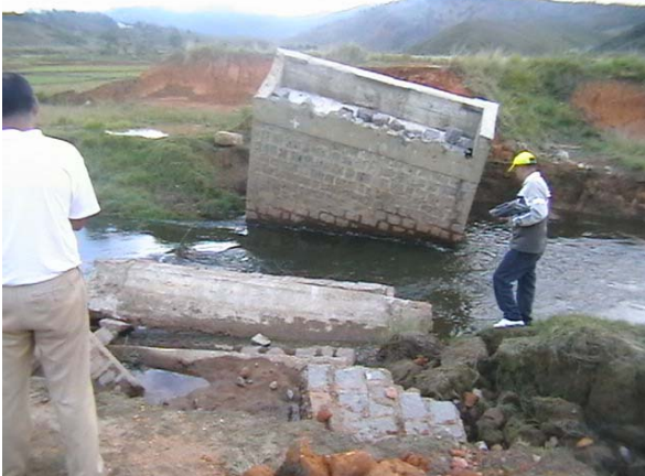
Les infrastructures construites par le projet ACORDS ont aussi subi (Pont coupé sur l'axe Vinanitelo – Sandranata)
